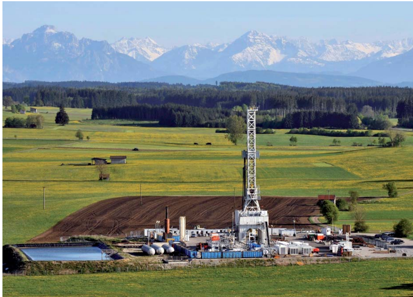
HEKLA ENERGY RIG: BENTEC EURO RIG 350 AC
